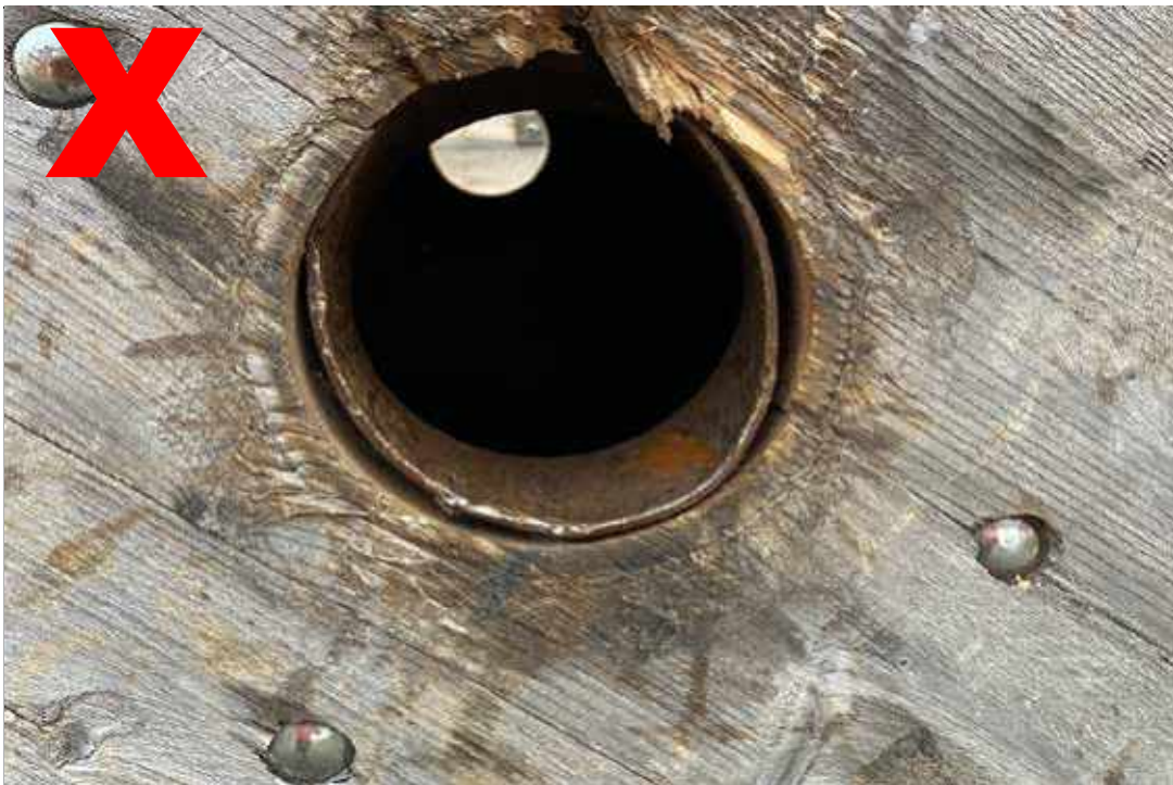
6. MO Metalliosia rikki/puuttuu
